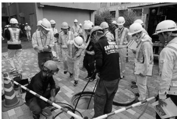
下水道（愛大構内）
