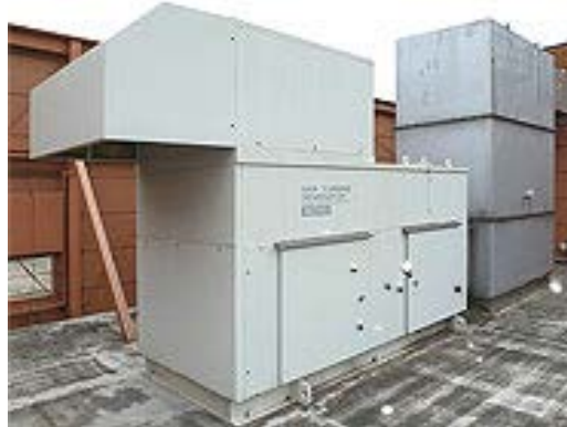
災害拠点病院等125箇所の自家発電設備の増設等の支援
