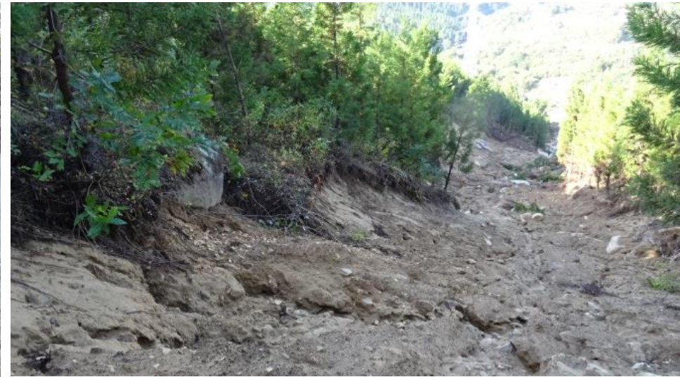
側方滑落面の上部：土砂化している
