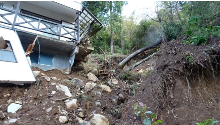
住宅背後地盤と側方地盤が崩落
