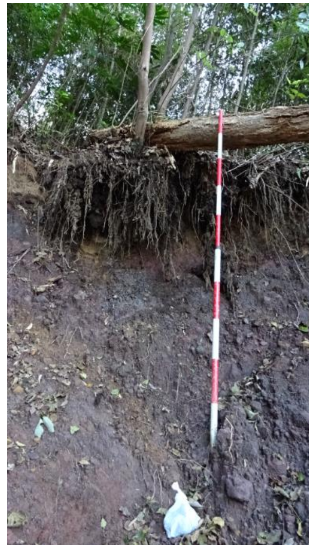
別荘地の住宅背後斜面崩壊
