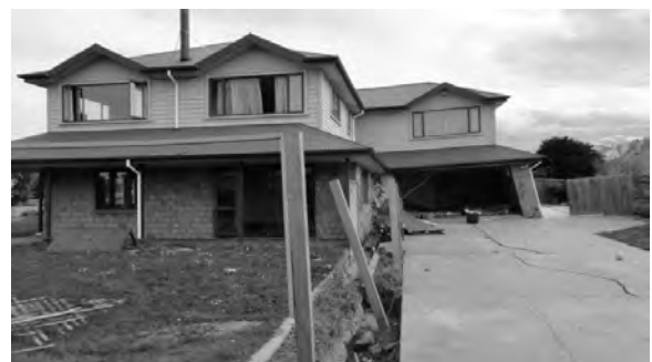
写真 5 液状化側方流動による家屋被害
