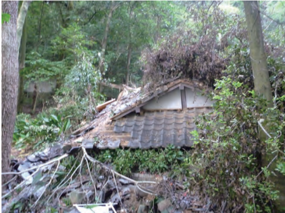
豪雨災害(松山・愚陀仏庵の倒壊)
