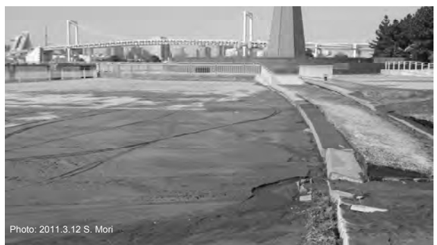
写真1 東京台場付近での岸壁背面の液状化
