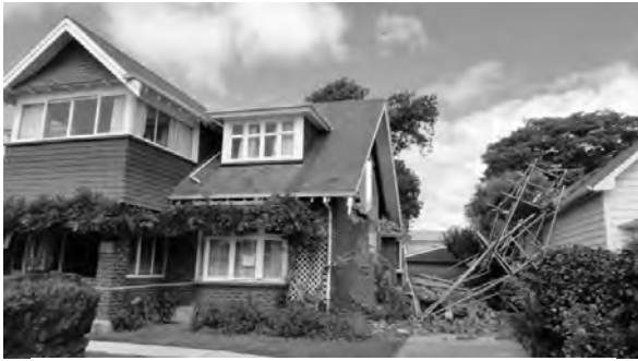
写真 2 住宅の被害（妻壁のレンガ脱落）
