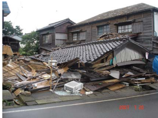
倒壊した家屋
