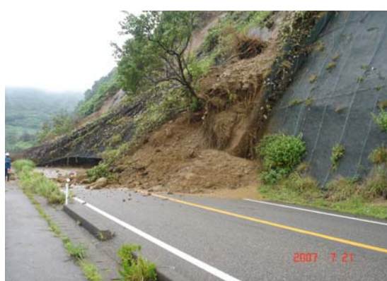
道路のり面の被害
