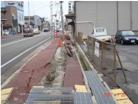
柏崎市街地の歩道の亀裂
