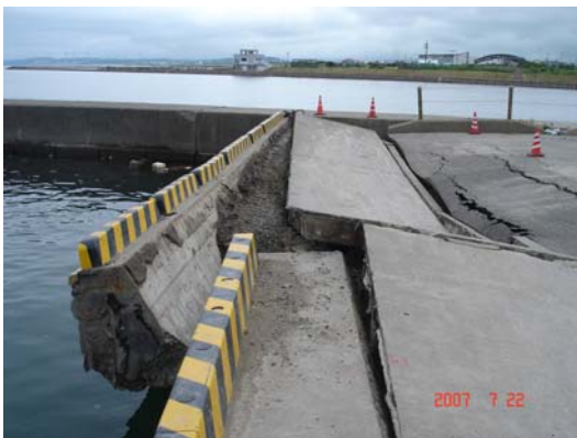
港湾施設の被害（柏崎港）
