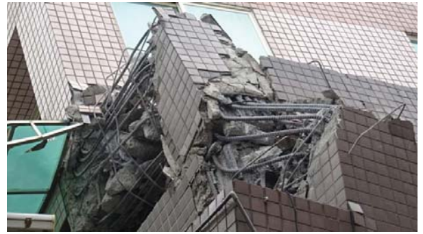
せん断補強筋(帯鉄筋)が少ない。定着が135度でなく、90度。
