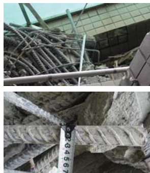
せん断補強筋(帯鉄筋)が少ない。鉄筋径が小さい、間隔が大きい。定着が135度でなく、90度。
