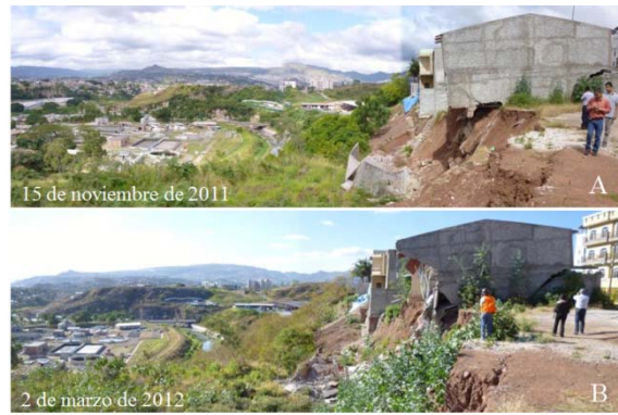
図 3.2. 旧地すべり頭部の盛土上に宅地造成後の地すべり再活動現場 (ミラフローレス・スル、上：2011年11月15日，下：2012年3月2日、廣田撮影).
