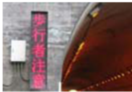
情報板の整備(国道56号 須崎市)
